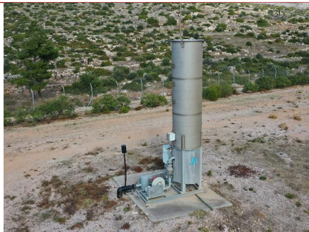
ΧΥΤΑ Χίου Πυρσός καύσης βιοαερίου
